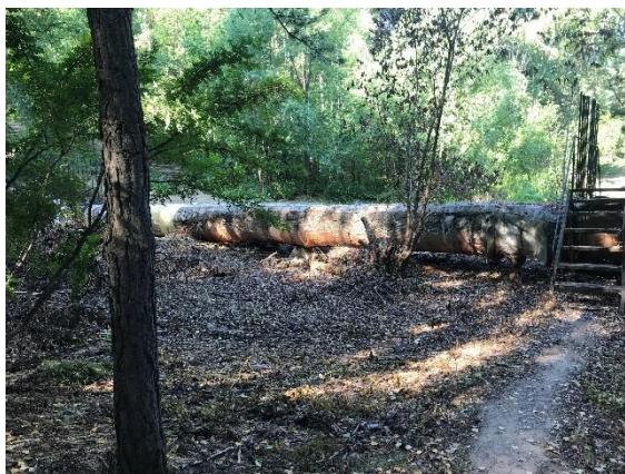
Фото 1. Сварившийся лес в месте разрыва теплотрассы
