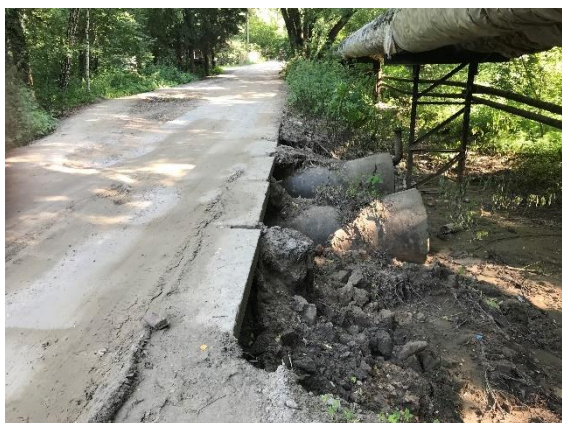
Фото 2. Размытая горячей водой дорога – результат испытания теплотрассы повышенным давлением
